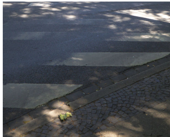
Bild 25: Die Bodenmarkierungen müssen regelmäßig aufgefrischt werden.
