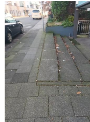
Schlecht erkennbare Stufen
