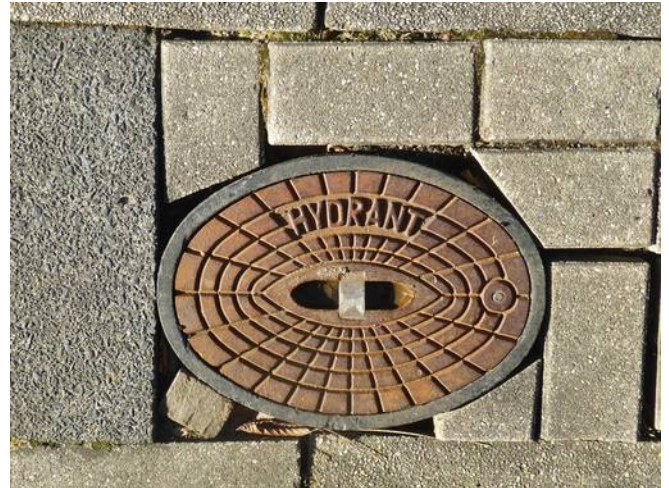
Bild 16: Hydranten im Gehweg benötigt die Feuerwehr.
