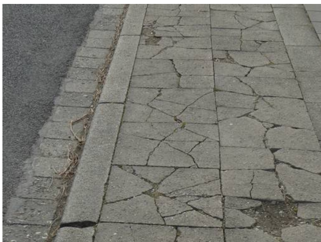
Bild 13: Typische Gehwegschäden durch zu schwere Fahrzeuge
