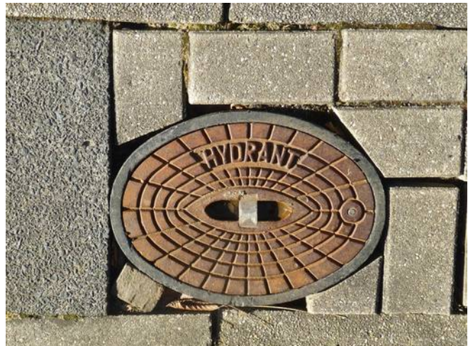
Bild 16: Hydranten im Gehweg benötigt die Feuerwehr.
