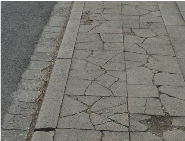
Bild 13: Typische Gehwegschäden durch zu schwere Fahrzeuge
