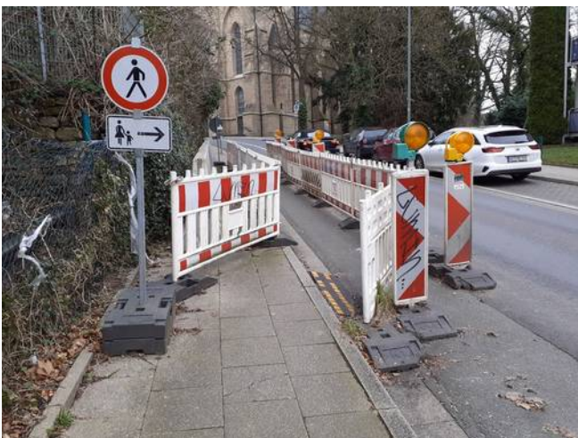
Bild 33: Eigentlich müsste jedes auf dem Gehweg parkende Auto so abgesichert werden.
